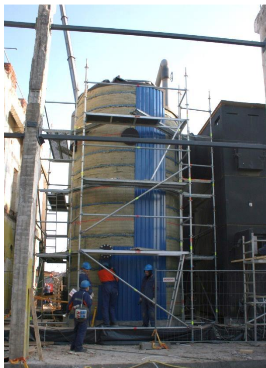
Izoliuojamas vandens šildymo katilas.
